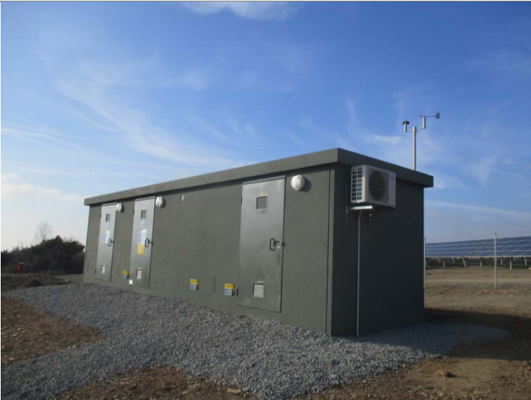
Photographie 2 : Exemple de la structure de livraison 2
